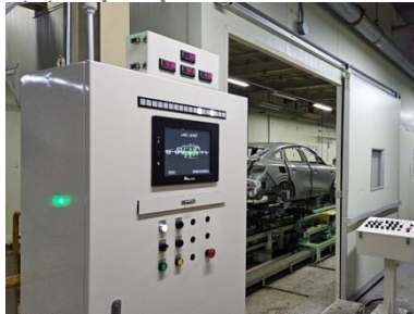
르*코리아 자동차 도장공장(LASD) CONVEYOR
