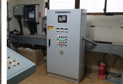
Smart Motor Controller (원격, 스케줄)
