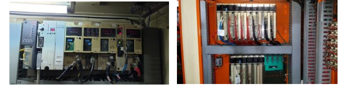
구형 PLC 설비 (약 15~30년 사용 설비)
